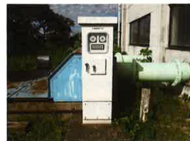
除塵機制御盤
