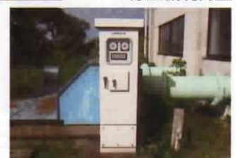
除塵機制御盤
